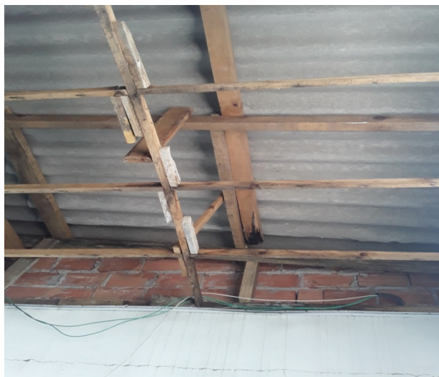
Figura 4 – parte do teto da sala 36 onde ocorreram vazamentos
