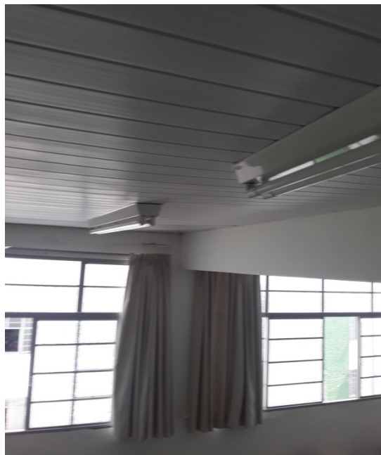
Figura 15 – Forro de PVC da sala 33. Nota-se deformação (flecha) pelas peças de madeira acima fletidas
