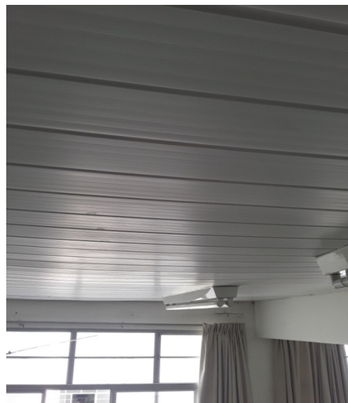
Figura 12 – Forro de PVC deformando devido à flexão das peças de madeira do entreferro na sala 33
