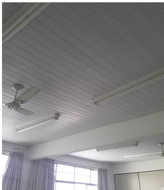
Figura 13 – Forro de PVC deformando devido à flexão das peças de madeira do entreferro na sala 33
