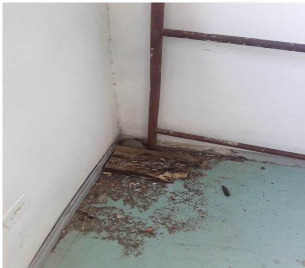
Figura 7 – pedaços de madeira que se desprenderam do teto da sala 32
