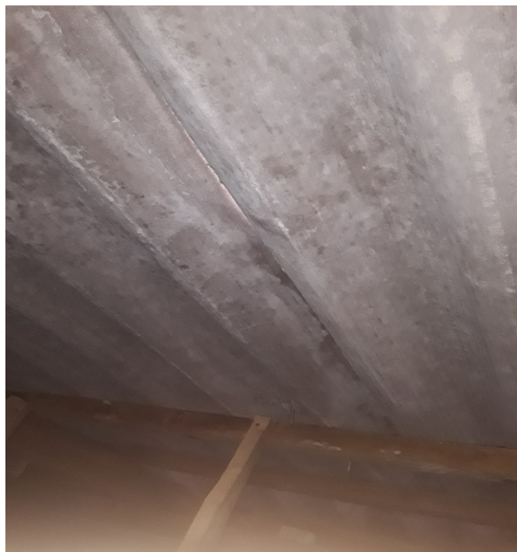
Figura 11 – Vista interna do entreferro do telhado da sala 34 – telha de fibrocimento
