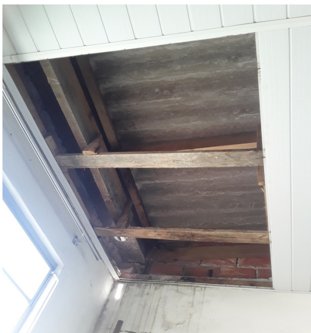
Figura 6 – Parte do teto da sala 32, onde ocorreram vazamentos
